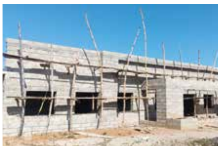
Um novo centro de saúde que está sendo construído pelo Barnabas no estado de Kaduna, na Nigéria, onde os Cristãos estão sujeitos a ataques constantes de Islamistas
